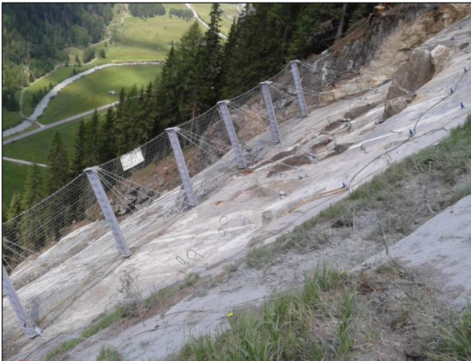
Abb.10: Hochenergieseilsperr e (5000 kJ) unmittelbar unterhalb Abbruchstelle, Blick nach NW, am 11.07.2013
