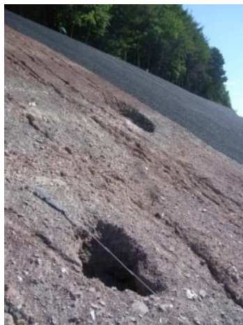
Bild 11: „Frischer“ Erdfall auf Böschung am Stützbauwerk BAB A38A
