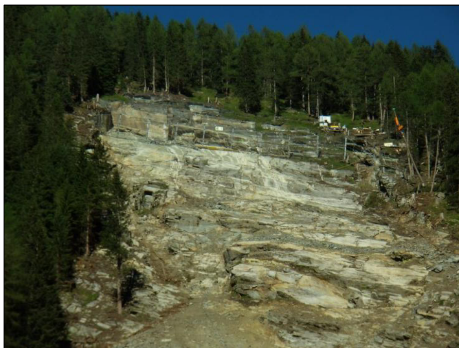
Abb.12: Übersicht Oberer / Mittlerer Felssturzbereich, am 01.08.2013; Blick nach E
