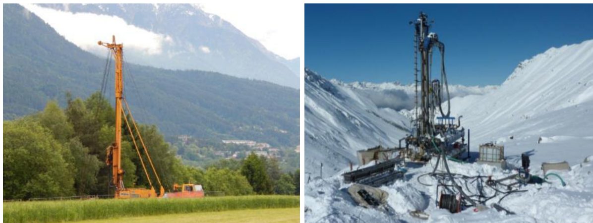
Abb.1: Erkundungsbohrungen im Tal (westliche Mittelgebirgsterrasse bei Innsbruck, links) und am Berg (Platzertal, rechts)
