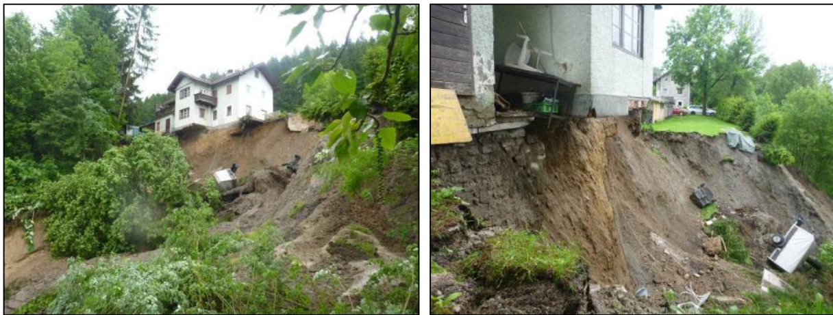
Abb. 5 Hangrutsch in Kirchbichl, der zur Freilegung des Fundamentes und zum Abriss des Gebäudes geführt hat
