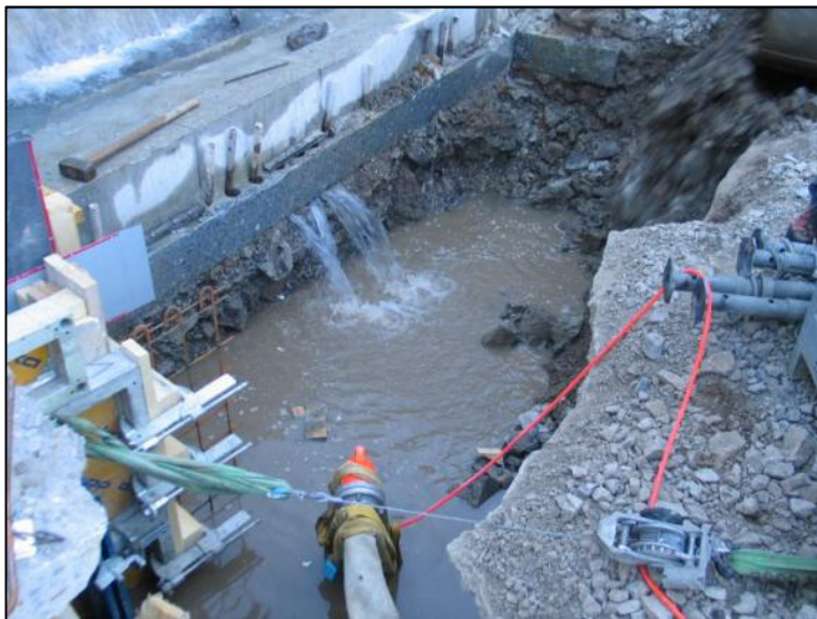
Abbildung 9 und 10: Unterströmung Fundament und Rohrschirm, Quellaustritte
