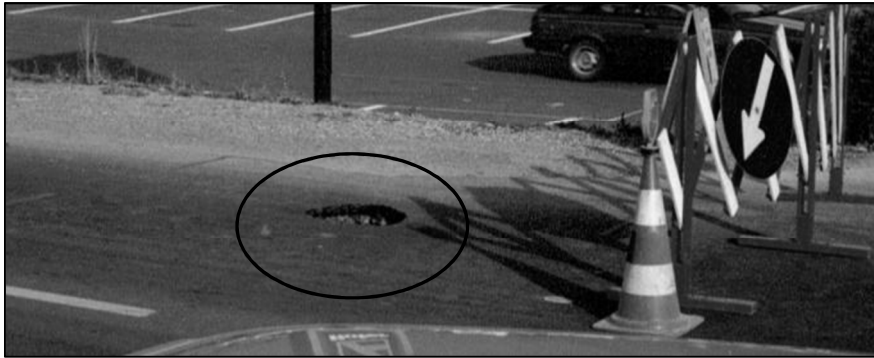
Abb. 4: Erdfall in der Innsbruckerstraße 1986 (Fotos BBA Reutte)
