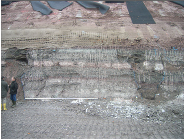
Bild 10: verfüllter Erdfall am Stützbauwerk BAB A38
