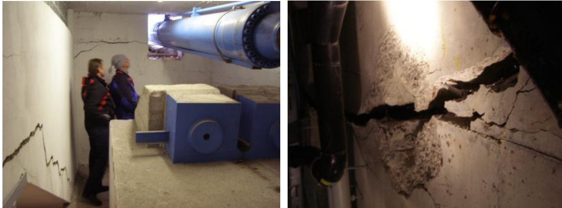
Bauwerksschäden 8EUB Gaislachkogel 2009
